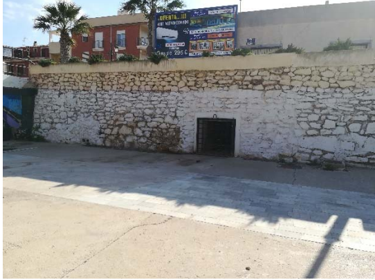
Imagen 7. Detalle salida pluviales red Dorada 1 en zona de Pescaderías.
